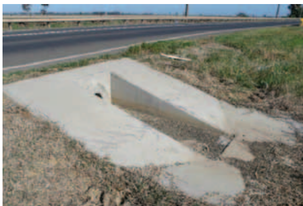
Откосные стенки 2-го типа, проходимые для АТС, подходят для ограждения выходов поперечных труб.
