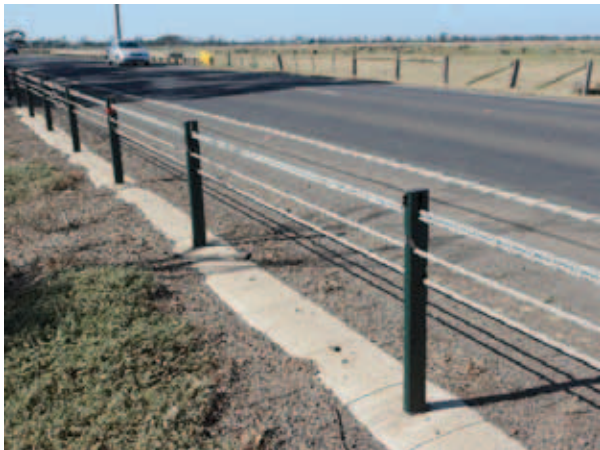
К эксплуатации допущены несколько видов тросовых ограждений. Из трех групп ограждений, тросовые являются самой щадящей группой.
