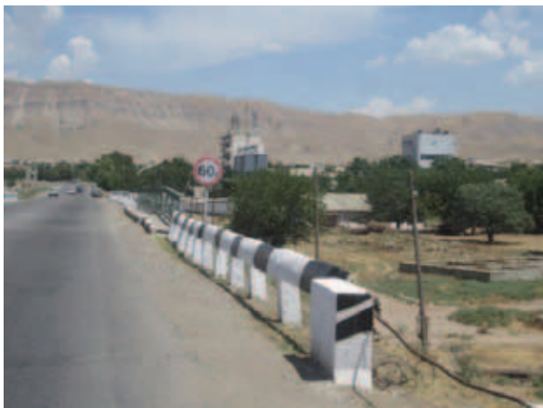
Железобетонные блоки и ограждения, подобные этим, являются опасными придорожными объектами. В лучшем случае, они могут лишь обозначать край дороги.
