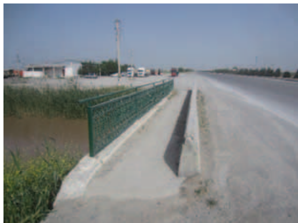
Мостовые перила должны быть достаточно прочными, чтобы удержать транспортное средство при ударе по ним. Показанные на фотографии перила небольшого сечения недостаточно прочны для этой задачи. Низкое бетонное ограждение – еще один опасный объект.
