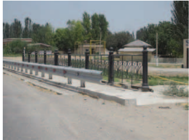
Установка ограждения без концевого элемента - это небезопасная практика. Ограждения не должны устанавливаться или эксплуатироваться в таком виде, так как горизонтальная балка может легко пробить кузов транспортного средства, потерявшего управление.
