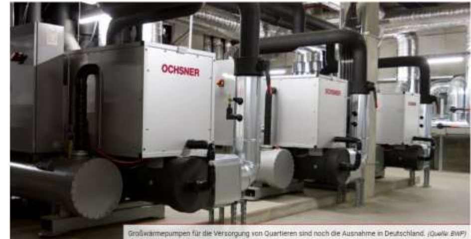
Großwärmepumpen für die Versorgung von Quartieren sind noch die Ausnahme in Deutschland. (Quelle: ZWP)
